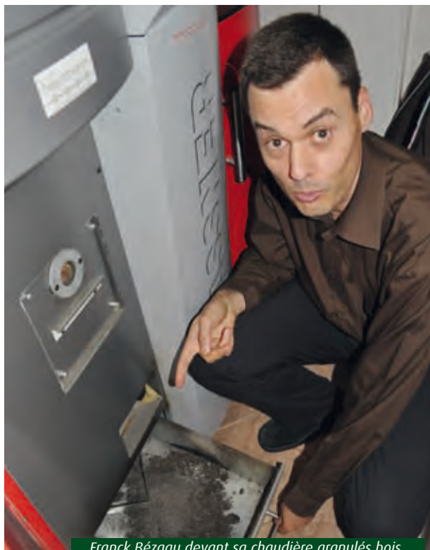
Franck Bézagu devant sa chaudière granulés bois.
